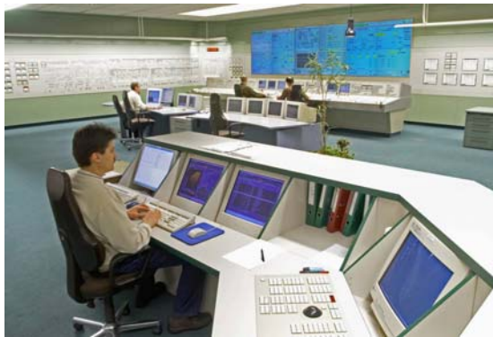
Abbildung: Simulator einer KKW Leitwarte
