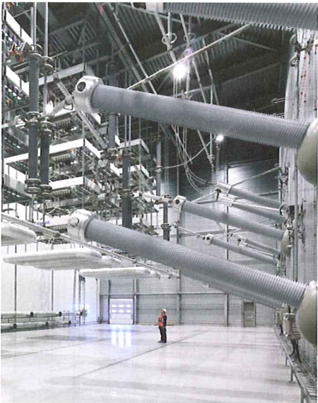
In dieser Halle bei Rotterdam wird das englische Stromnetz mit dem niederländischen verbunden. Ein wichtiger Knoten für das Supergrid. SEITE 78
